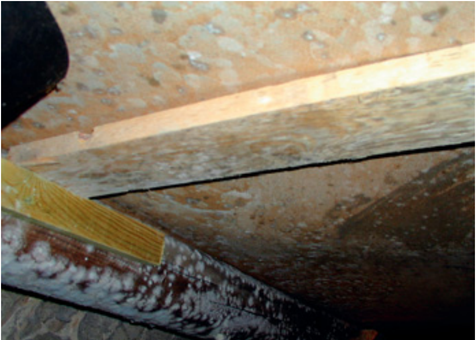
Krybekælder med manglende udluftning.
