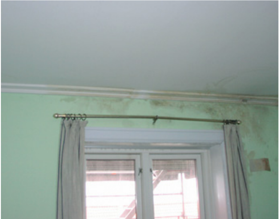
Fugtindtrængning ved tag.
